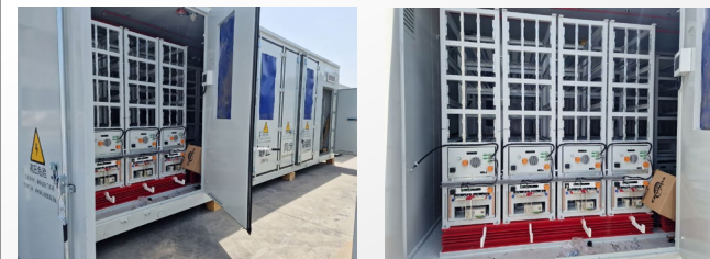
Установка после ГПП
